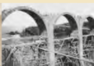
Construction du viaduc de la Petite Ravine (J. Adrien Blondel), [1878-1882]. Bibliothèque de géographie, 100 02 01 02
